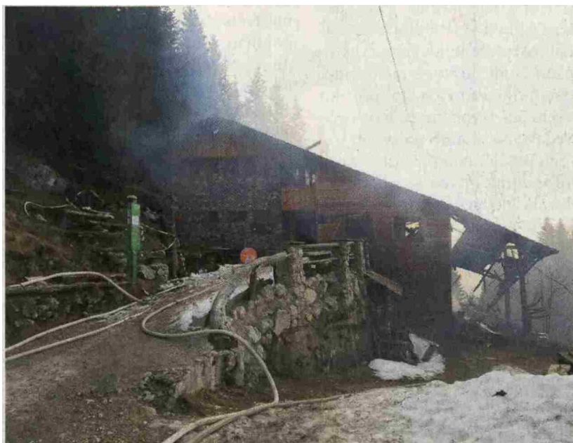
Od Mozirske kočje, ki so jo pred desetimi leti temeljito prenovili, ni ostalo veliko. A kaj je vzrok požara? Koča je bila prazna, na kurišču je gorelo nazadnje pred tednom dni. / foto: PGD Mozirje
