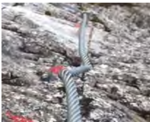
Slika 33: Poškodbe jeklenice – krotovičenje, nastalo pri napačnem odvijanju
