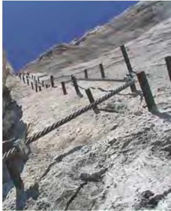
Slika 52: stopni klini predstavljajo povečano nevarnost poškodb
