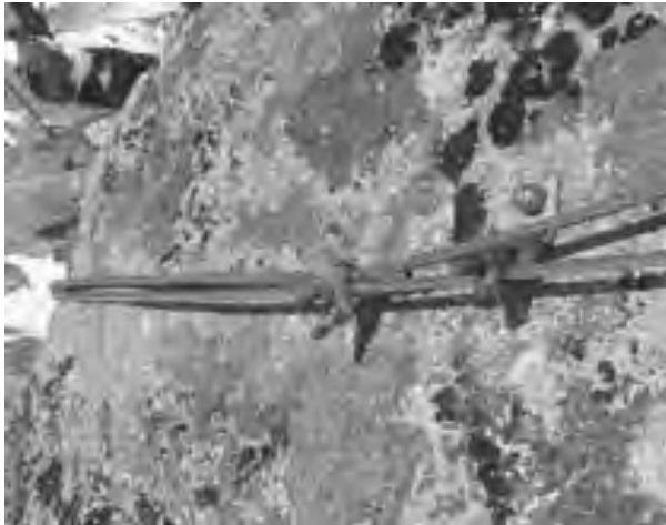
Slika 41: jeklenica se dotika stene, neznana varnost sistema, fiksiranje jeklenice na nestandardizirano sidro, ki bo poškodovalo jeklenico
