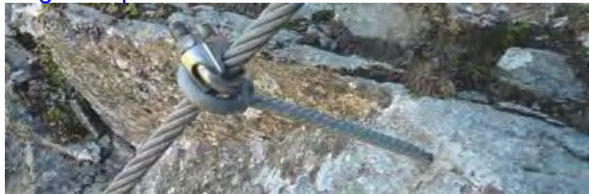
Slik 36: Uporaba neatestiranih očesnih matic brez prečne nosilnosti; Glede na premer sidra je njegova zunanja dolžina opazno prevelika, obstaja velika verjetnost utrujanja materiala; neprimerna uporaba spojke za jeklenico.
